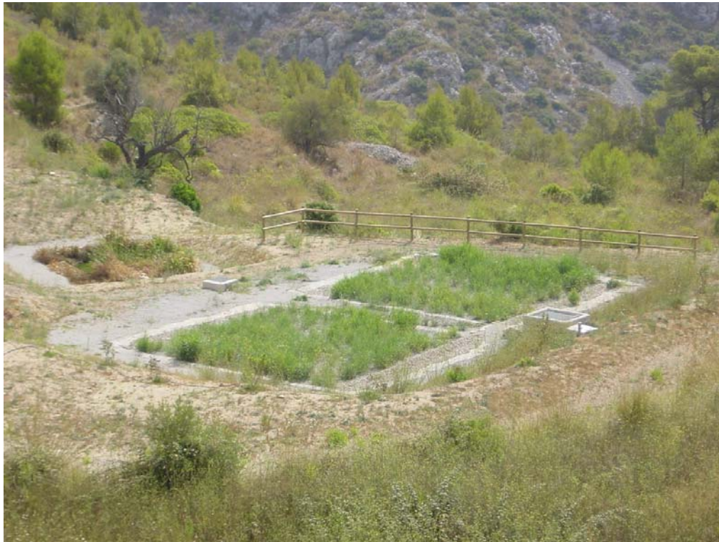
Vista general de la depuradora natural de Can Grau 2 mesos després de l'execució i en ple funcionament.
